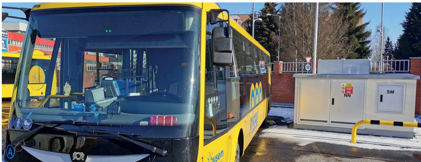
Nová trafostanice s autobusem.
